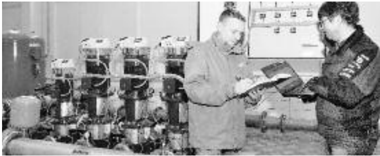
Bernd Scheppan, Leiter Wasserwerke bei der LWG (li.), gemeinsam mit dem Kollegen der beauftragten Fachfirma bei der Inbetriebnahme der neuen Pumpenanlage Foto: SpreePR/ Petsch
