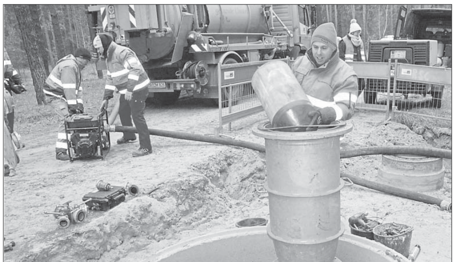
Kollegen der LWG und einer Fachfirma aus Forst (Lausitz) bei der gemeinsamen Vorbereitung für die Molchung der Abwasserdruckleitung zwischen Kolkwitz und Sielow Foto: LWG
