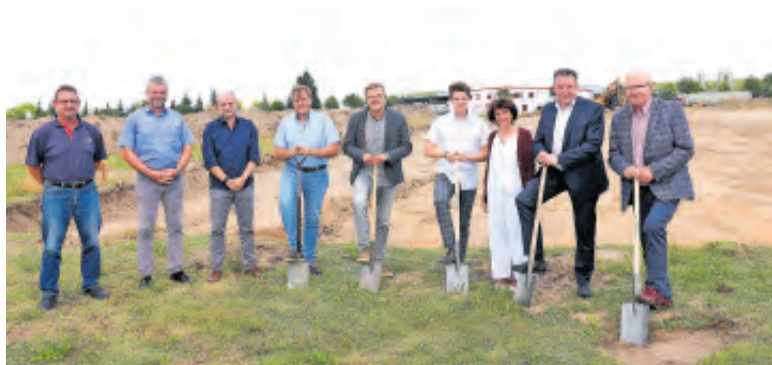
Eine gute Nachricht aus dem Krieschower Gewerbegebiet. Vier Millionen investiert die Dr. Butze GmbH & Co KG in diesen Standort. Im Juni war erster Spatenstich für das neue Logistikzentrum. Kommendes Jahr erfolgt der Umzug von Babow nach Krieschow.
