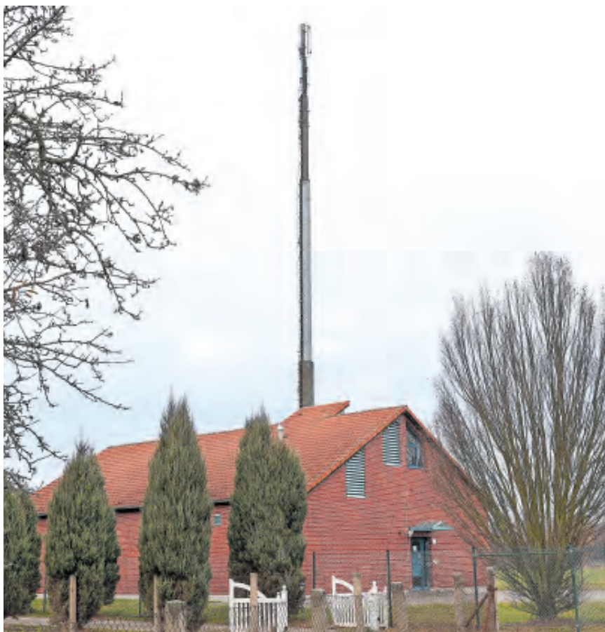
In der Schulstraße in Kolkwitz ist im Sommer der erste Mast mit Mobilfunk der 5. Generation (5G) in Betrieb gegangen Foto: Mathias Klinkmüller
