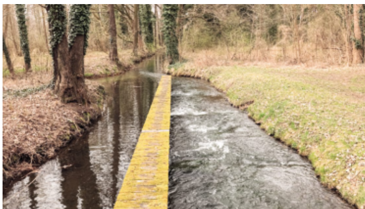
Blick von der Brücke Richtung West: Die neu gebaute Fischtreppe ist rechts zu sehen; links läuft das Wasser wie bisher mit Gefälle durch das Wehr. Hinten links ist der Einlauf des Moorgrabens zu sehen; dieser verschmutzt den Priorgraben, der hinten weiterläuft gen Westen.
